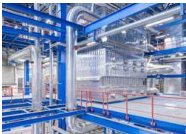
Blick in das Innere des neuen, 2023 in Betrieb genommenen, Bio-masse-Heizkraftwerks, das mit dem Hauptbrennstoff Altholz in umweltschonender Kraft-Wärme-Kopplung Strom und Wärme erzeugt.
