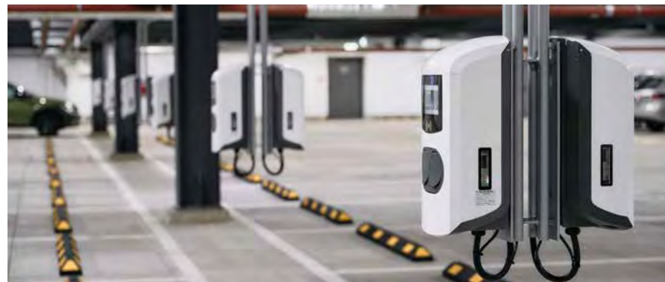
Ladeinfrastruktur BraWoPark: Im Parkhaus des Braunschweiger BraWoParks hat das Team um Ivo Grünhagen Anfang dieses Jahres 70 Ladepunkte für E-Autos in Betrieb genommen. Der Strom stammt vorrangig von der Photovoltaikanlage, die auf dem Dach des Parkdecks bereits im Sommer 2024 installiert wurde. Die Besucher und Mieter des BraWoParks haben seitdem die Möglichkeit, ihre Elektrofahrzeuge bequem während ihres Einkaufs, beim Bummeln, Essengehen oder Arbeiten aufzuladen.
